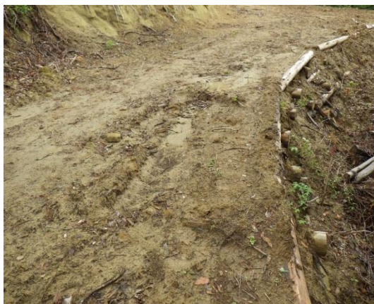
丸太組による盛土の締め固め不良
