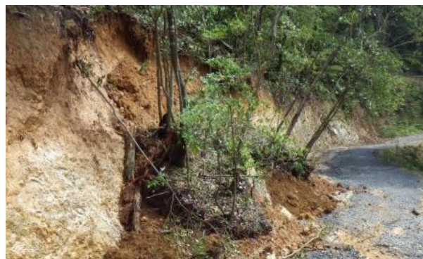
切り土法面の崩壊
