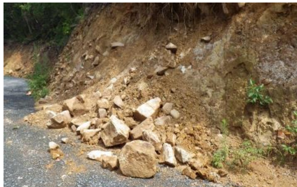
法面崩壊による落石
