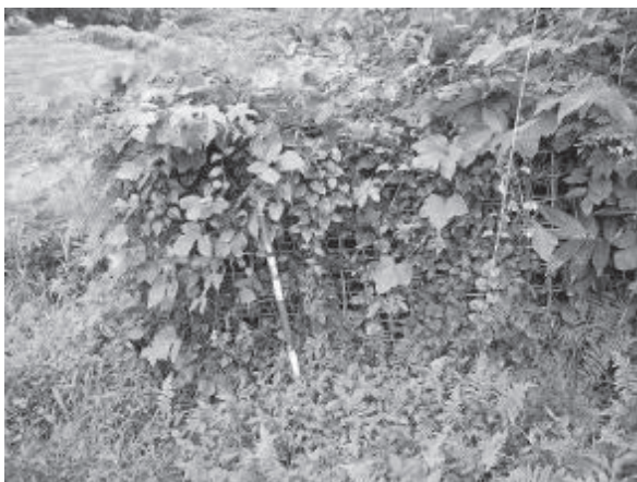
写真-1 維持管理を実施していない防護柵
