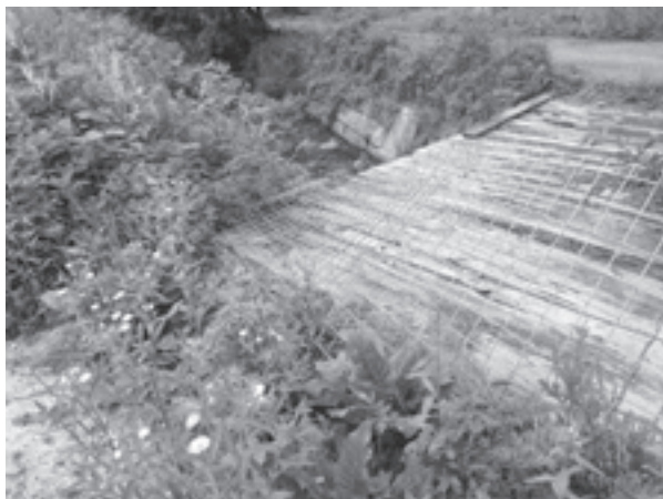
写真-1 雑草の繁茂による柵の倒壊
