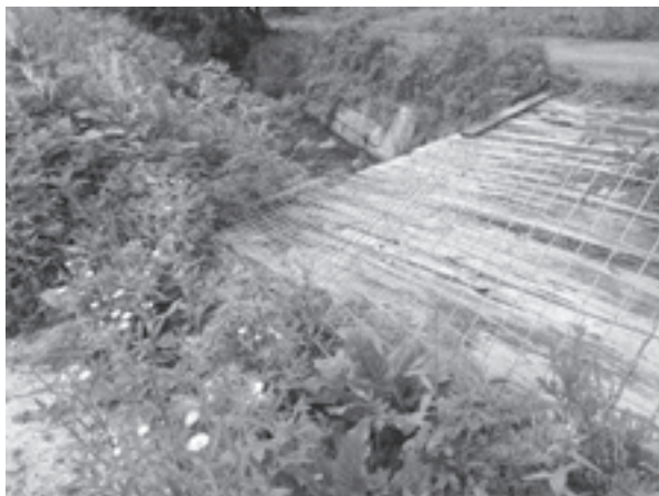
写真-1 雑草の繁茂による柵の倒壊
