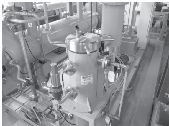
写真－1 注入処理装置
