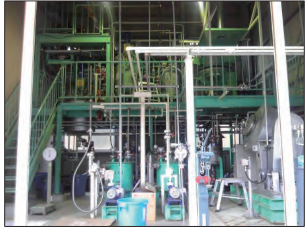
▲木質バイオマスリグノフェノール製造施設
