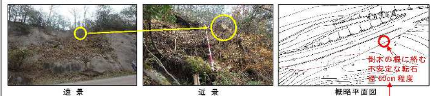
国道 191 号: 不安定な転石を確認 HM191A2610 (2024.10.20)
