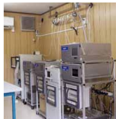
(写真2) 測定局の中の様子
