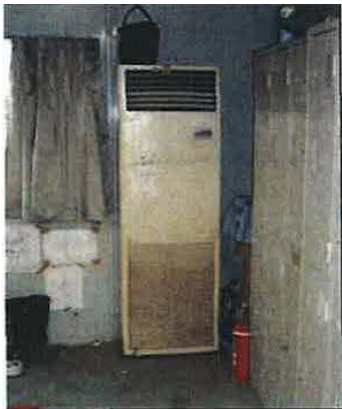
写真 3 : 休憩所に設置したエアコン
