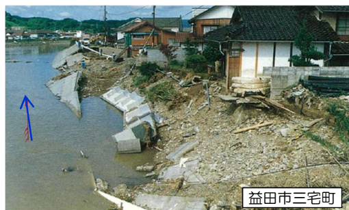
被災状況（益田川）
