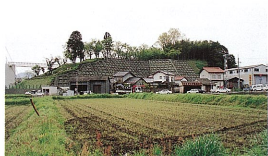
法枠工（大東町） 周辺景観に配慮した着色コンクリート吹きつけ
