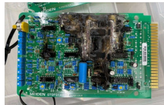
③雷害を受けた基盤(三成発電所)
