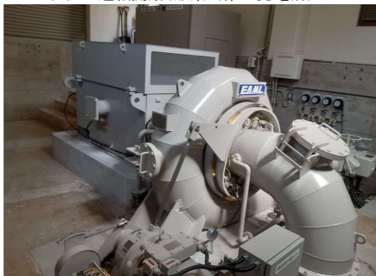
(1) FIT運転開始(飯梨川第三発電所)
