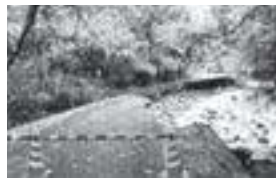
路体の流出状況
