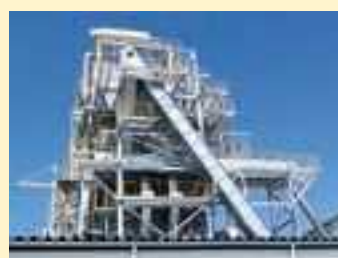
松江バイオマス発電株式会社 (松江市大井町) ボイラー 発電規模 6,250kw
