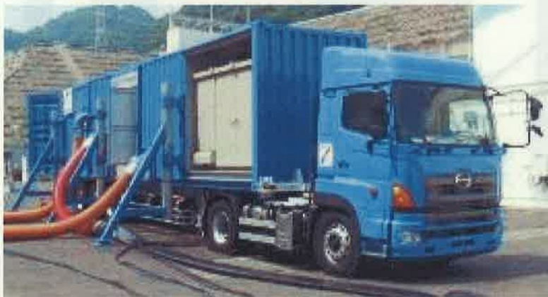
▲ 敷地内に配備した移動式代替熱交換設備
