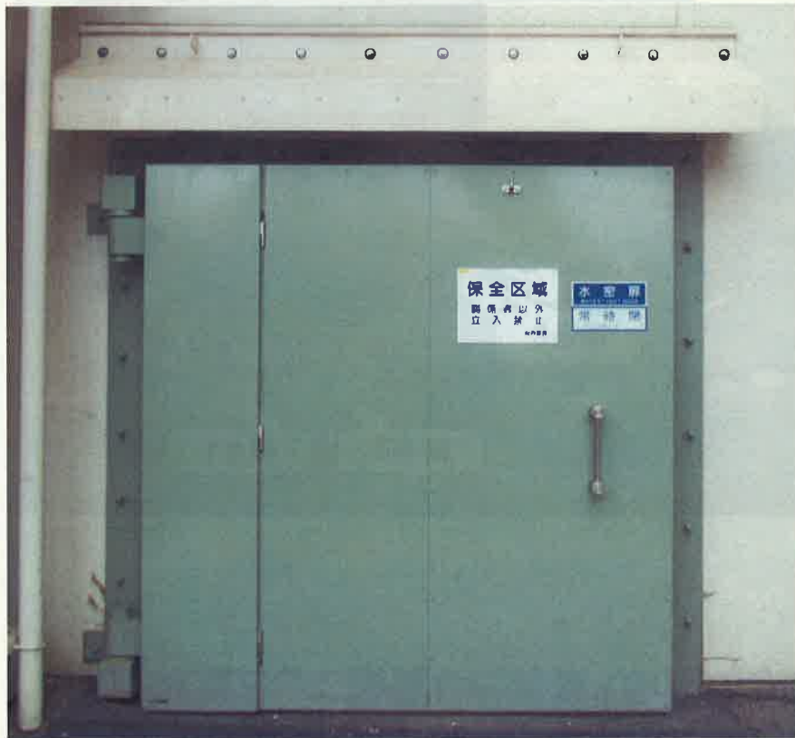
▲2号機建物外壁に設置した水密扉
