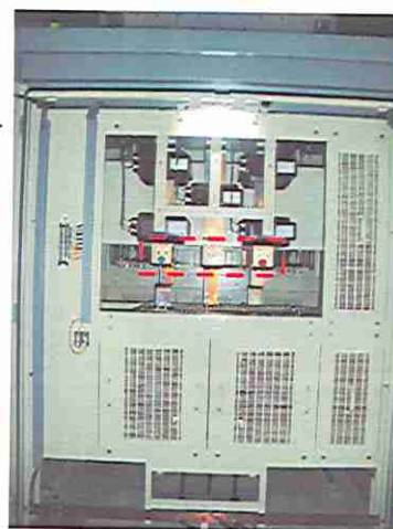
予備変圧器 (盤内ケーブル接続箇所)
