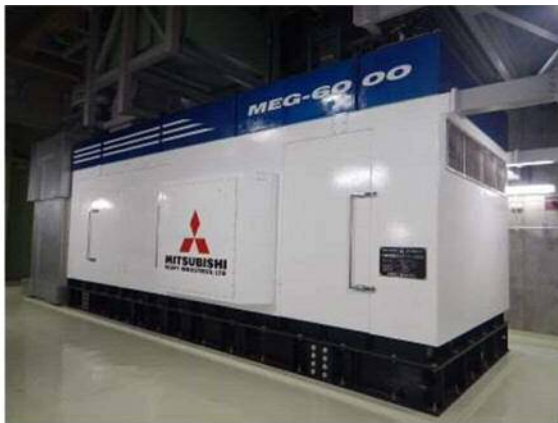
ガスタービン発電機 外観
