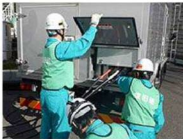
高圧発電機車による電源供給訓練
