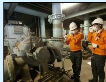
火力発電所での現地研修
