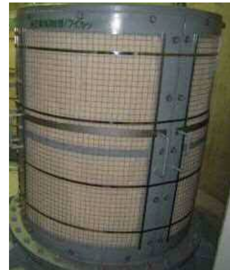
図 非常用ディーゼル発電機給気フィルタ
