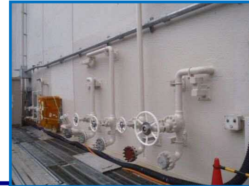
原子炉建物 南側 接続口
