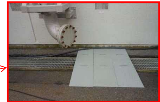
淡水供給側接続口
