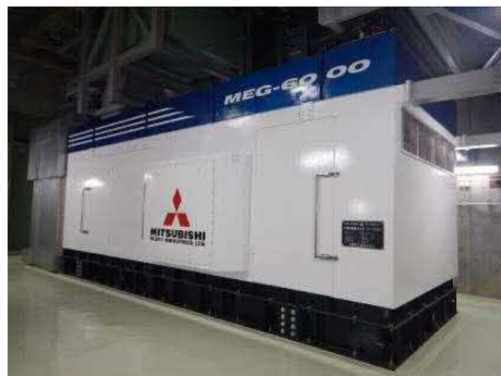
ガスタービン発電機 外観
