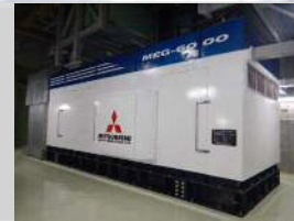
ガスタービン発電機
