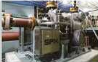
高圧原子炉代替注水ポンプ
