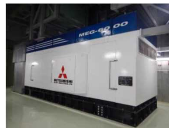
ガスタービン発電機
