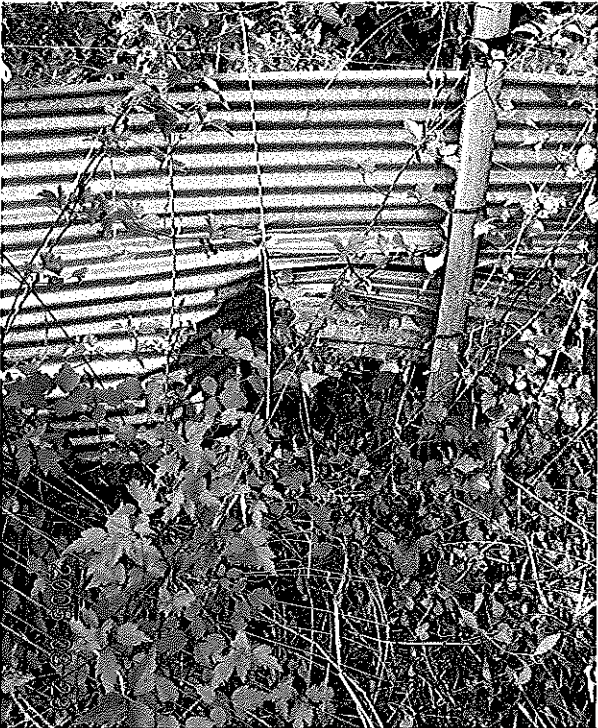
写真9 突破されたトタン柵 (山間地域)
